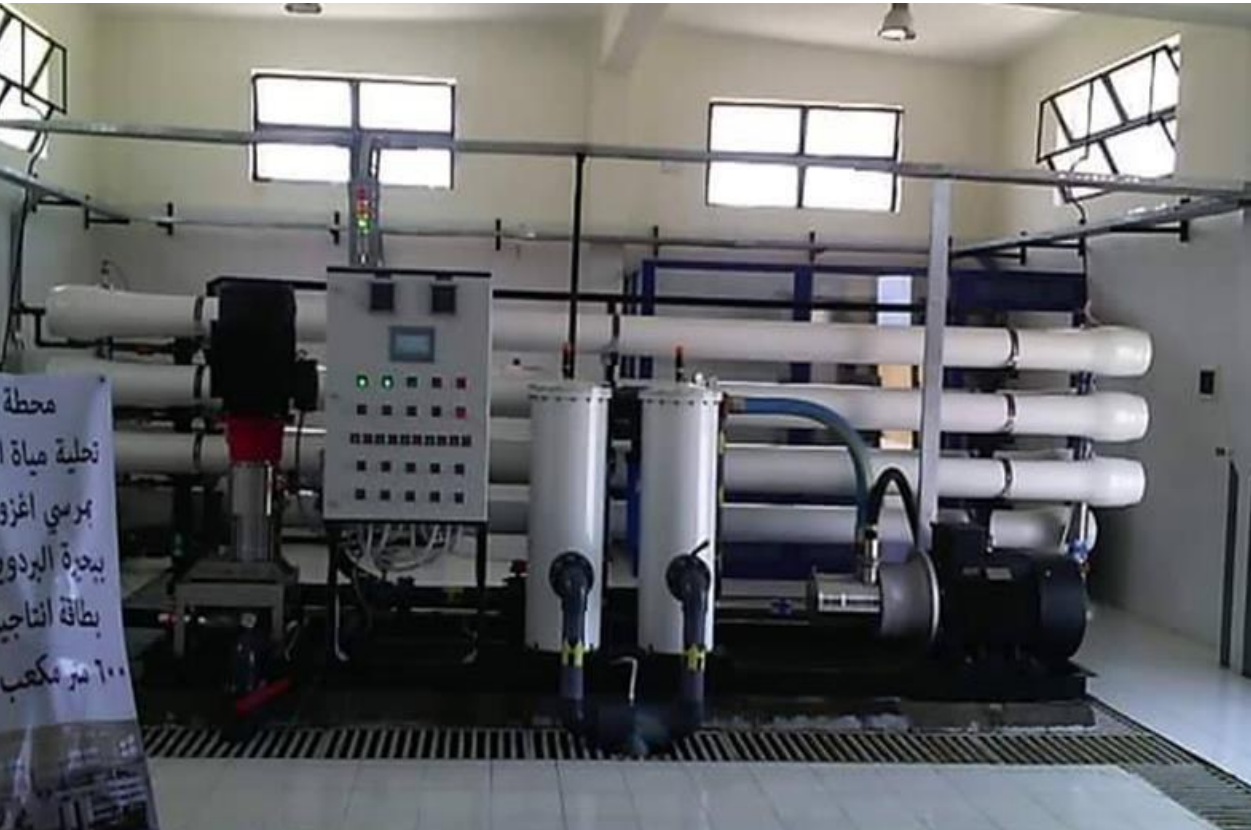
محطة تحلية مياه البحر ببحيرة البردويل بشمال سيناء (١٠٠ م ٣ /يوم)
