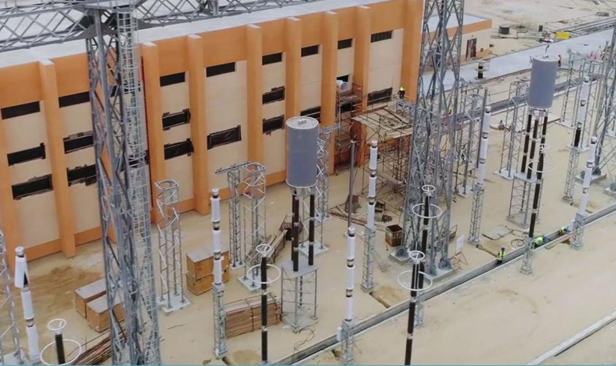
محطة كهرباء الإسماعيلية الجديدة بتكلفة ٣٥ مليون جنيه
