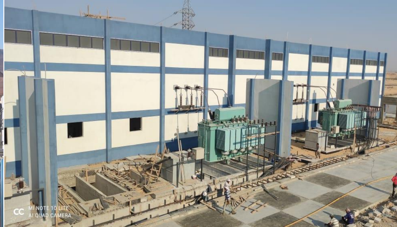
محطة محولات شرق بورسعيد
